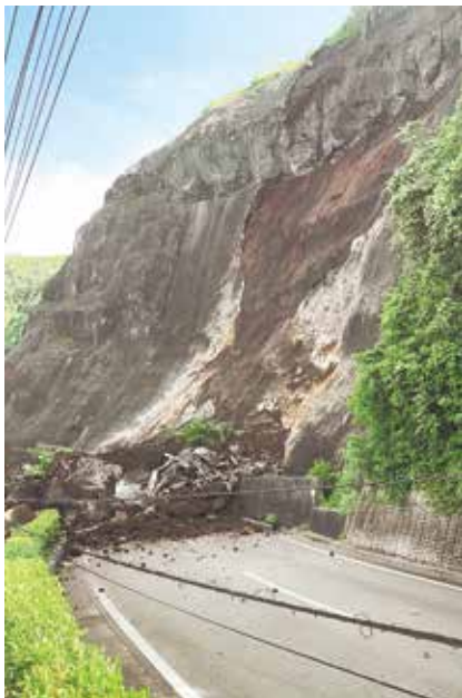
大久保地区の富士見橋付近での斜面崩落
