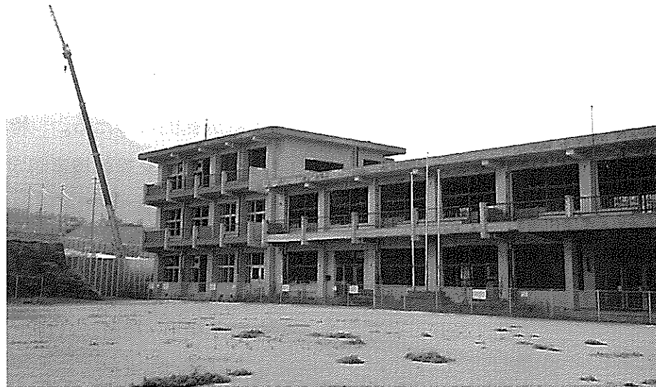
火砕流で窓ガラスも溶け、焼けただれた 深江町立大野木場小学校校舎
